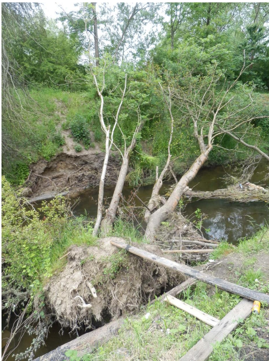
Fot.11. Skutki erozji brzegów rzeki.
